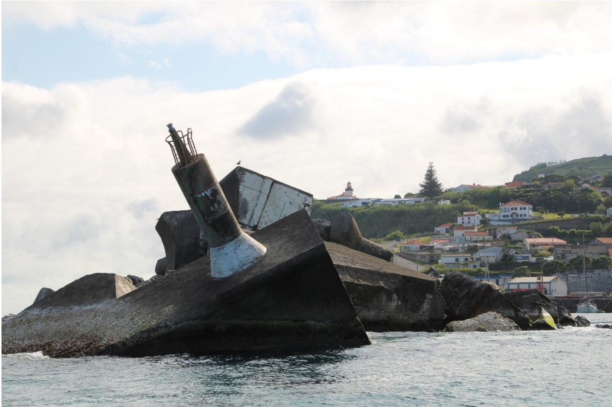
El dique de Flores destruido por una tormenta
